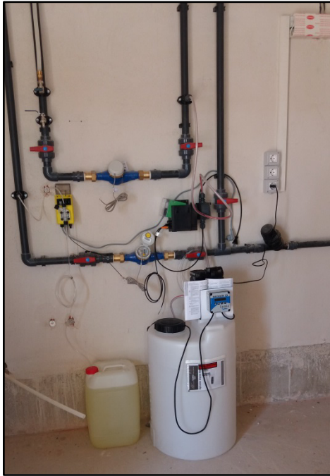
Ilustración 3. Una correcta calidad físico-química y microbiológica del agua de bebida es imprescindible. Todas las instalaciones de postdestete y cebo deben contar con equipos de dosificación de higienizantes.
