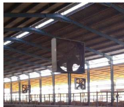
Ventiladores para mover y renovar el aire.
