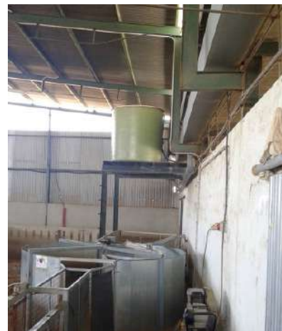
Depósito de agua en una granja.
